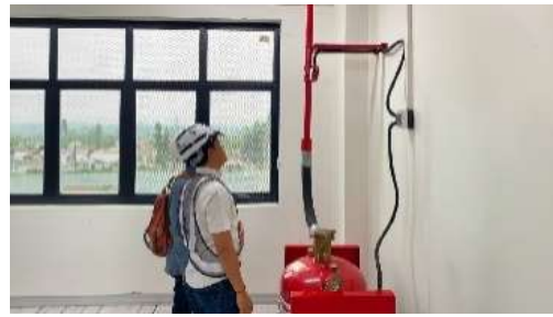
FM200 Fire Suppression System PT. WIKA Gedung Tbk Stasiun Kereta Cepat KCIC Padalarang
