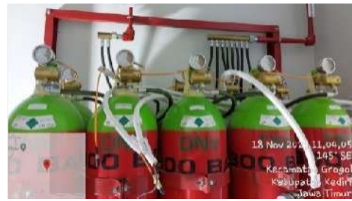
Inergen Fire Suppression System PT Wijaya Karya (Persero) Tbk Bandara Doho Kediri
